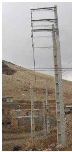
گفت: برق‌رسانی به روستاهای از اهمیت خاصی برخوردار است. برق‌رسانی به این روستاها به ادوات و تجهیزات پیشرفته و مناسب نیاز دارد و باید این تجهیزات با شرایط سخت کاری در
